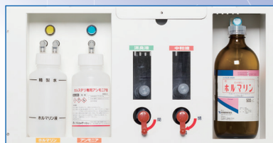
ホルマリン液自動注入装置
